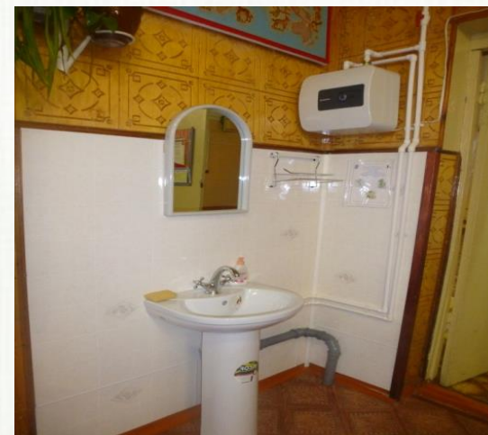
Подводка горячей и холодной воды в кабинеты химии, изо, биологии, обслуживающего труда
